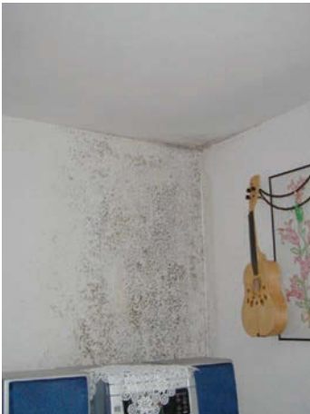
Schimmel tritt vor allem im Winter gehäuft auf. Betroffene Bereiche müssen grundlegend saniert werden.
